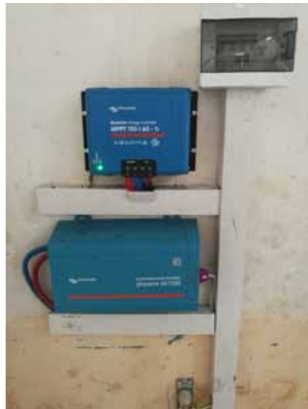
Le matériel est installé selon les normes en vigueur
