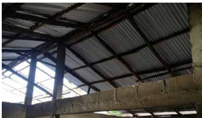
L'espace entre le toit et le futur plafond qui sera fixé au niveau des poutres permet d'évacuer la chaleur
